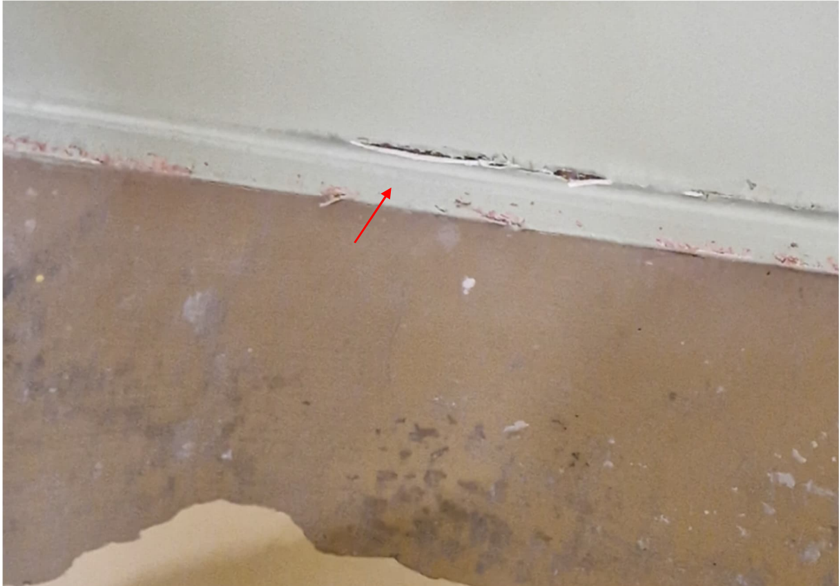
Mynd 8. Skemmdir tengdar vatnsnotkun.
