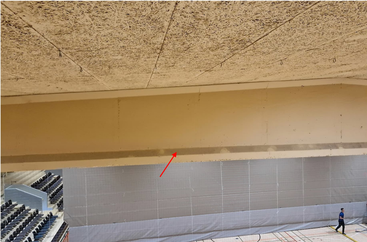
Mynd 4. Óhreinindi á strengjasteypu
