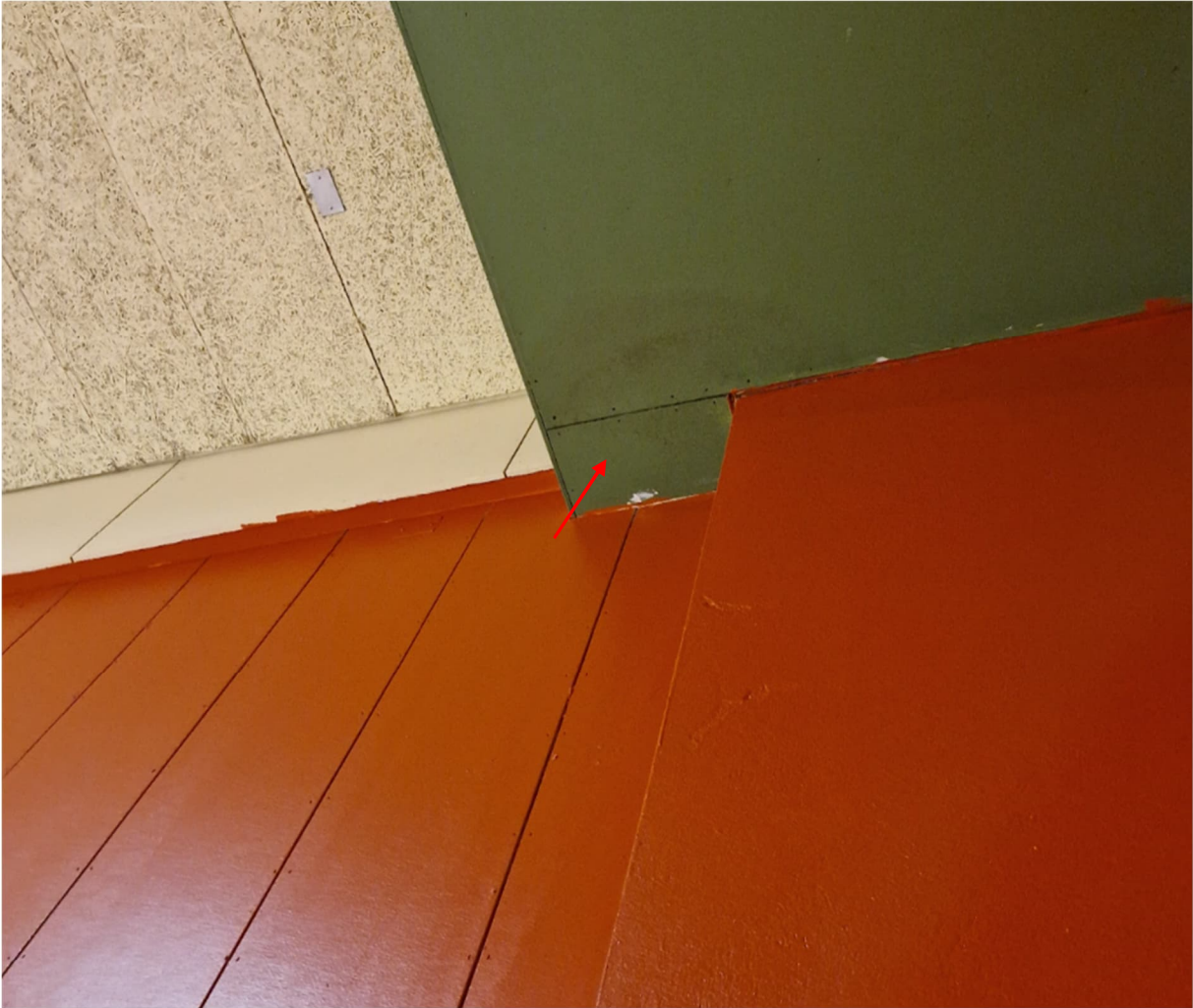
Mynd 7. Skemmd tengd niðurfalli.
