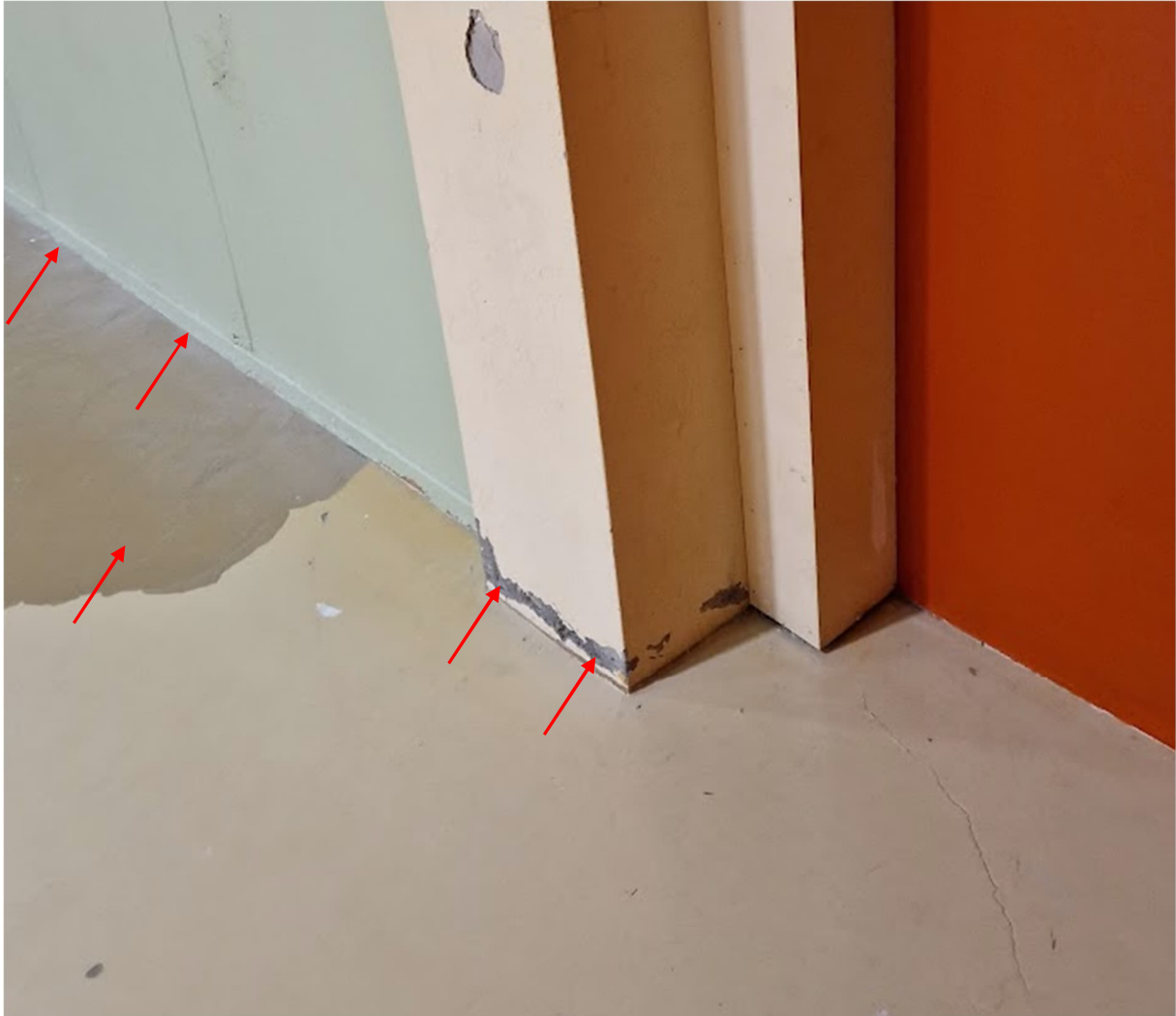
Mynd 9. Skemmdir tengdar vatnsnotkun.
